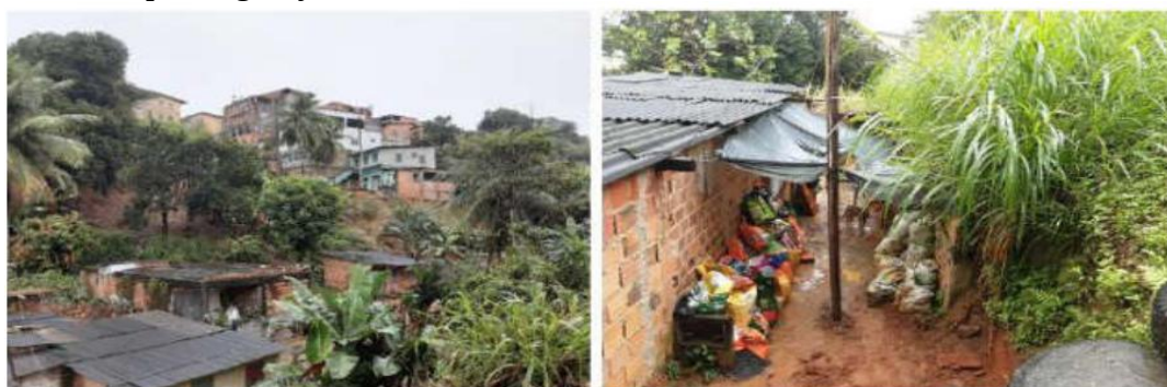
Figura 16 - Registro fotográfico da encosta da Vila Irmã Dulce, Cajazeiras VI, com cobertura por vegetação ineficiente e descarte de lixo/entulho. Salvador, 2025.
